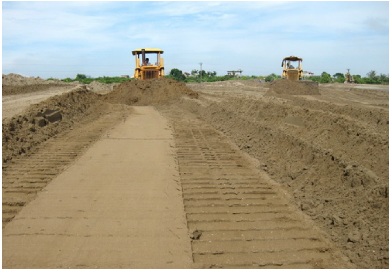
Hình ảnh thi công đường ô tô cao tốc Hà Nội - Hải Phòng
