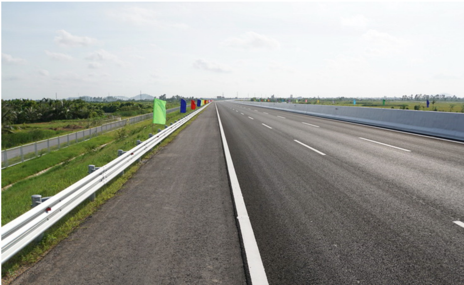
Đường ô tô cao tốc Hà Nội - Hải Phòng (ảnh: Trí unv)
